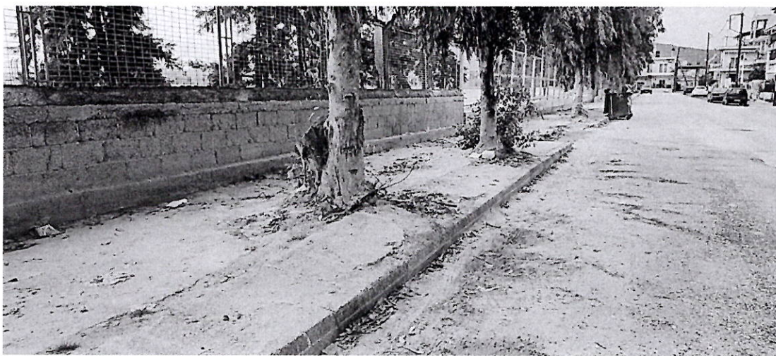
Εικόνα 6 - Πεζοδρόμιο οδού Βότση
